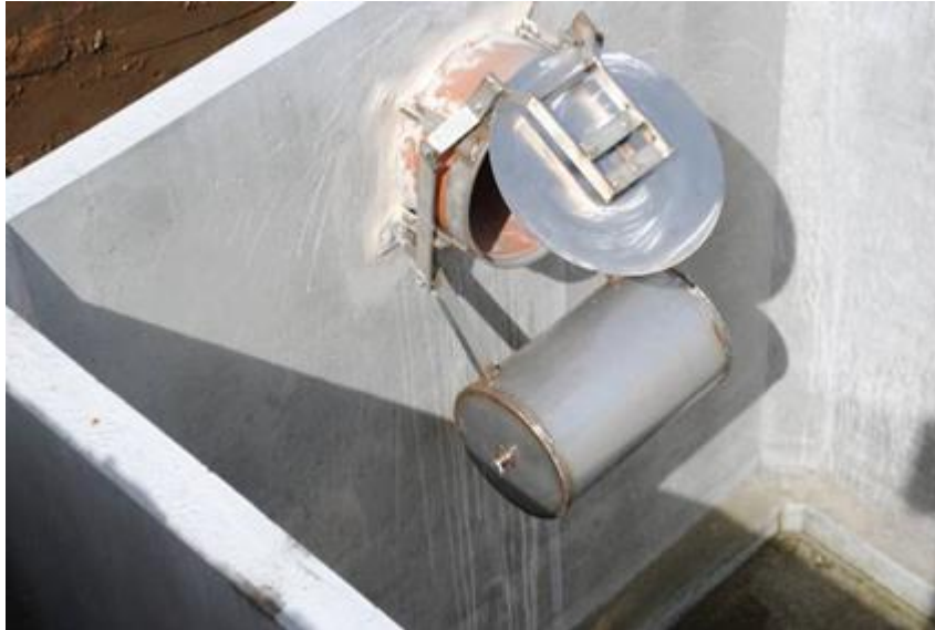
Fig.3.2.3. Valvola automatica in grado di bloccare il deflusso quando viene raggiunto il livello massimo di accumulo di idrocarburi.
